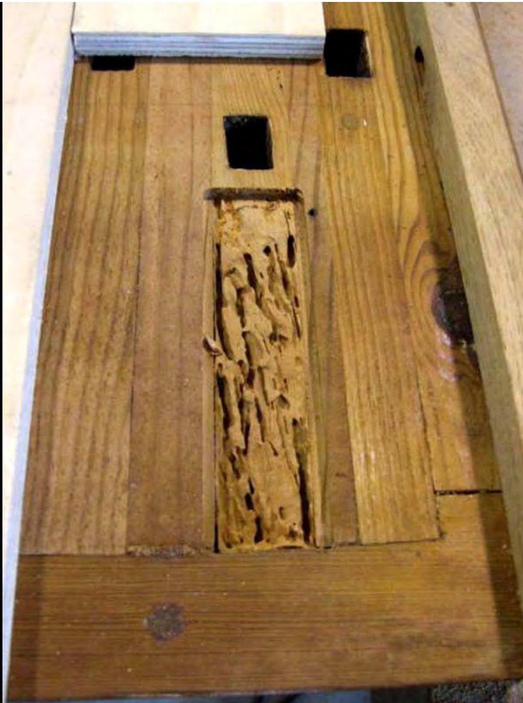
Detalle de una parte del secreto atacada por xilófagos
